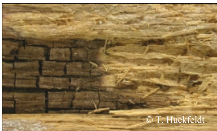
Abb. 1. Braun- und Weißfäule an einem Holzstück aus einem Dachboden. Braunfäule (Hausschwamm) links mit Würfelbruch und deutlich dunklerer Farbe als die Weißfäule (Hausporling) rechts.
