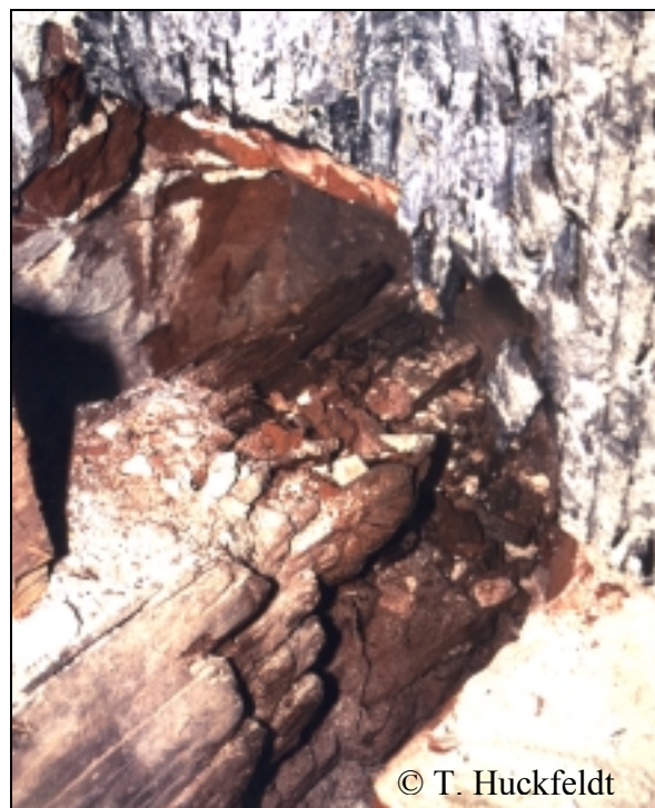
Abb. 2. Ein durch den Echten Hausschwamm ( Serpula lacrymans ) zerstörter Balkenkopf eines Fußbodens im Mauerauflager (freigelegt); Balken 18 x 24 cm. Ein Größenvergleich der Hyphen im Holz ist in Abb. 8 gezeigt.
