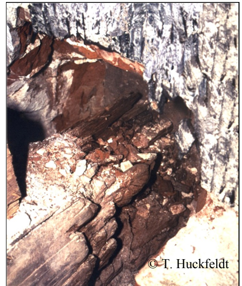
Abb. 2. Ein durch den Echten Hausschwamm ( Serpula lacrymans ) zerstörter Balkenkopf eines Fußbodens im Mauerauflager (freigelegt); Balken 18 x 24 cm.
