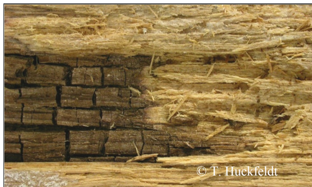
Abb. 1. Braun- und Weißfäule an einem Holzstück aus einem Dachboden. Braunfäule (Hauschwamm) links mit Würfelbruch und deutlich dunklerer Farbe als die Weißfäule (Hausporling) rechts.
