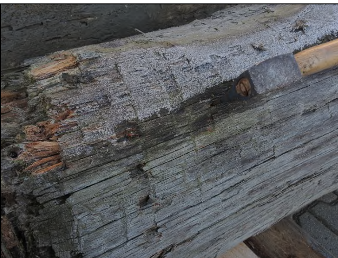
Abb. 51: Oberes Ende einer gezogenen Dalbe (Nordsee): Von außen ist kein Schaden erkennbar.
