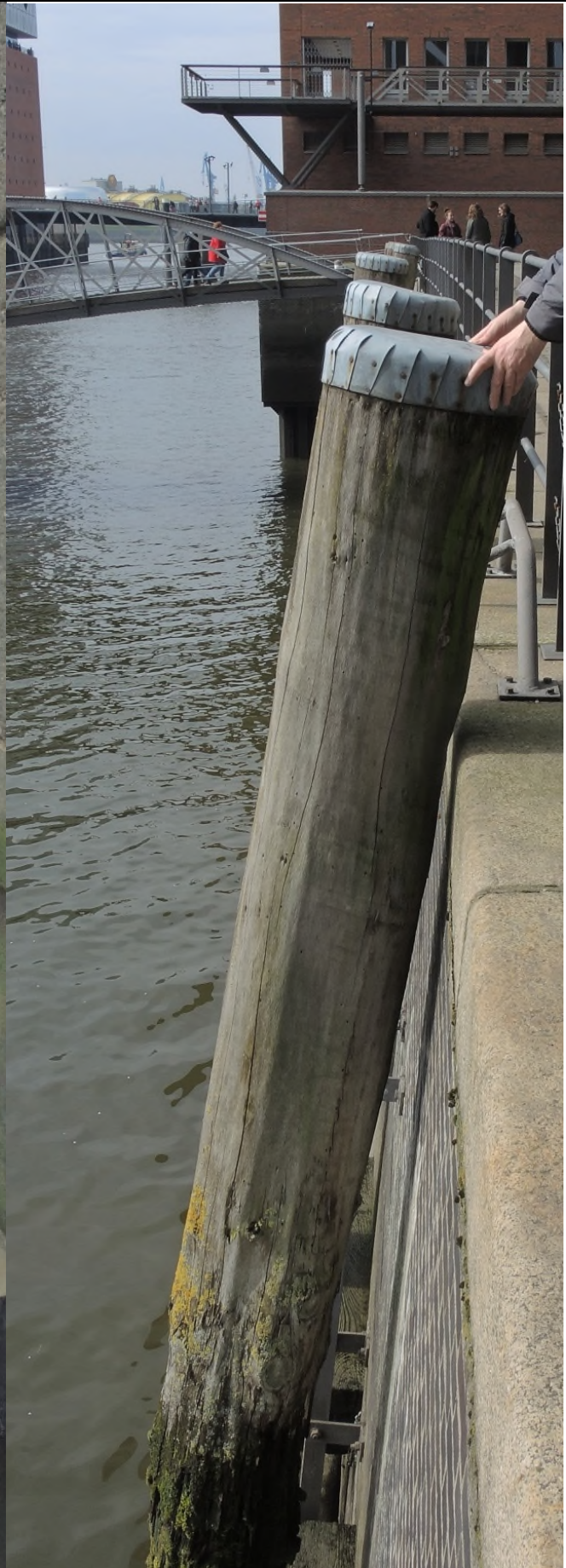
Abb. 70: Hamburg, Museumshafen, Am Sandtorkai; Nordseite des Hafenbeckens, ohne Probenahme, massiv geschädigte, sich an die Haufenmauer anlehende Dalbe, die sich hätte umkippen lassen. Ein massiver Schaden ist nur im Bereich oberhalb des Tidenhubes deutlich.
