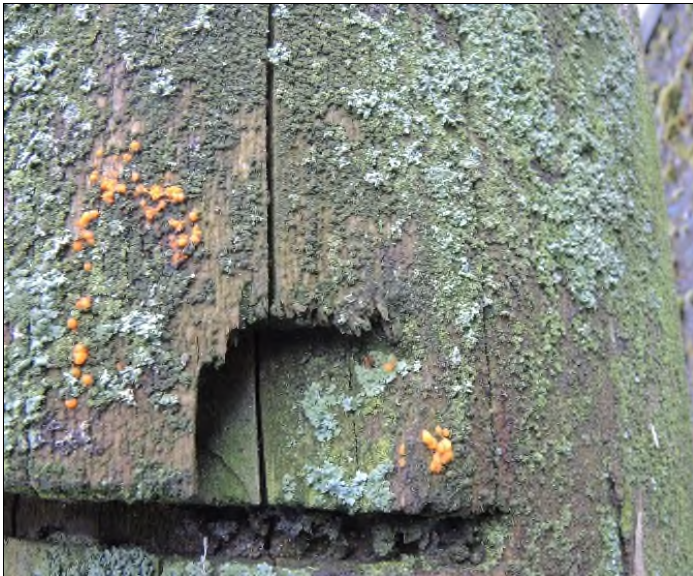
Abb. 63: Braunfäule-Erreger: Zerfließende Gallerträne ( Dacrymyces stillatus ); Fundstelle: Hamburg; Am Sandtorkai; Südseite des Hafenebeckens; Dalben im Museumshafen, Probenpunkt 7; Kopf des Balkens.
