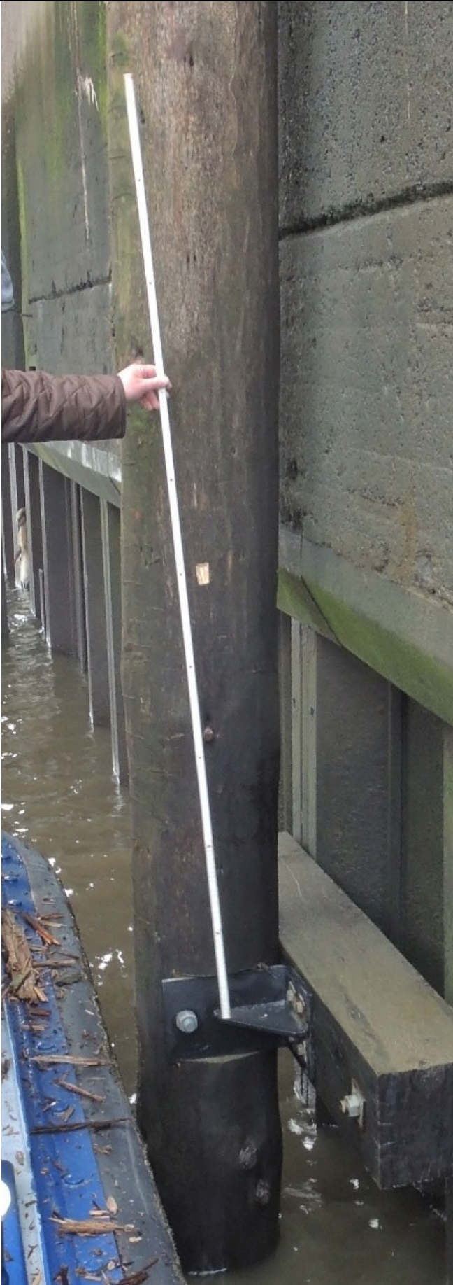
Abb. 69: Hamburg, Einfahrt Museumshafen, unterhalb der Mahatma-Gandhi-Brücke; Südseite des Hafenbeckens, Kontrollprobe „neue Dalbe“ (ca. 1 Jahr alt) ca. 150 cm über Wasseroberfläche; Probenahme: 30.03.2017.
