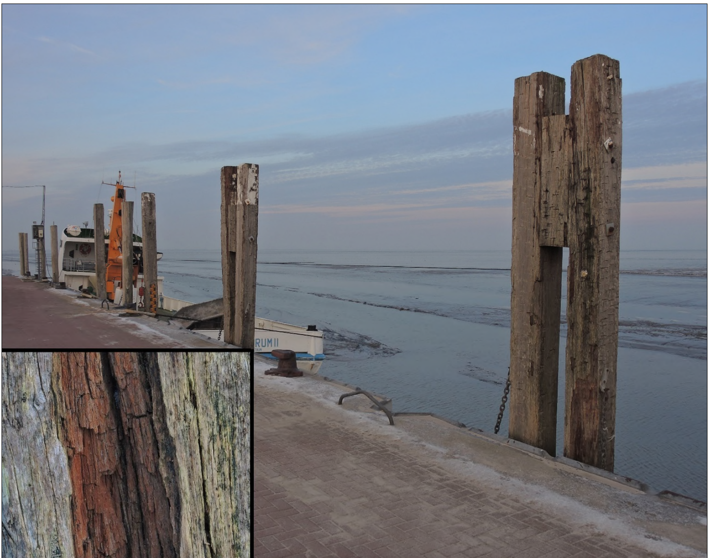
Abb. 1: Typische Dalben einer Hafenanlage mit sichtbaren Fäuleschäden (Nordsee, Niedersachsen, Nessmer-Siel, 22.01.2016); Eckbild: Braunfäule-Schaden nach Prüfung; das Holz war mit dem Daumen eindrückbar.
