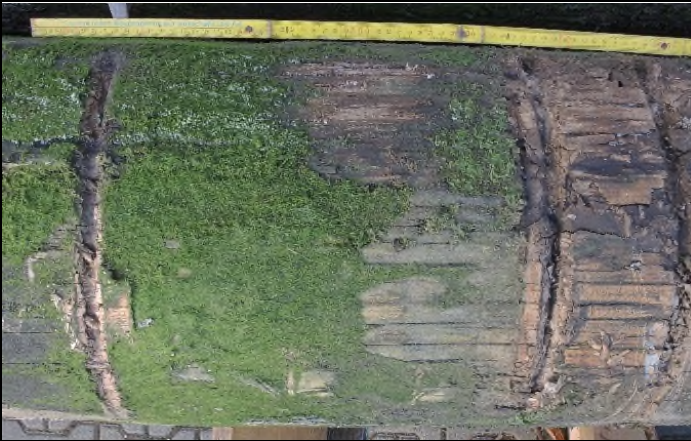
Abb. 47: Dalbe im Bereich etwas oberhalb der Wasser-Luft-Zone (Tidenhub), viele Luftalgen, aber auch Moose siedeln sich hier an.
