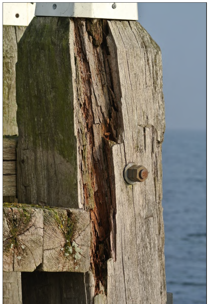
Abb. 7: Ostsee: Typischer Braunfäuleschaden an einer Dalbe; die Abdeckung ist zu knapp bemessen.
