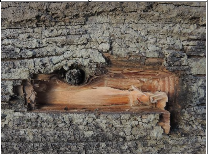
Abb. 46: Eine Probennahme aus diesem Bereich zeigt einen oberflächlichen Schaden, das Holz im Inneren ist hart, frisch und hell.
