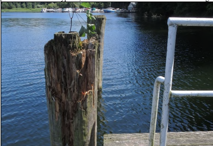
Abb. 9: Dalbe ohne baulichen Holzschutz. Im Süßwasser ist der obere Teil oft am stärksten gefährdet. Oberer Teil massiv braunfäulig und final zerstört; der untere Teil ist deutlich weniger angegriffen.
