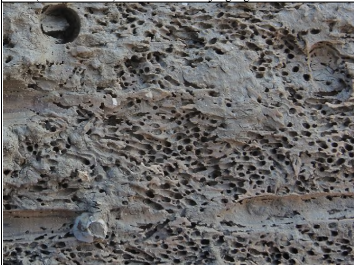
Abb. 43: Dalbe mit Bohrsessel-Befall ( Limnoria lignorum ) mit vielen feinen Bohrgängen im Holz.
