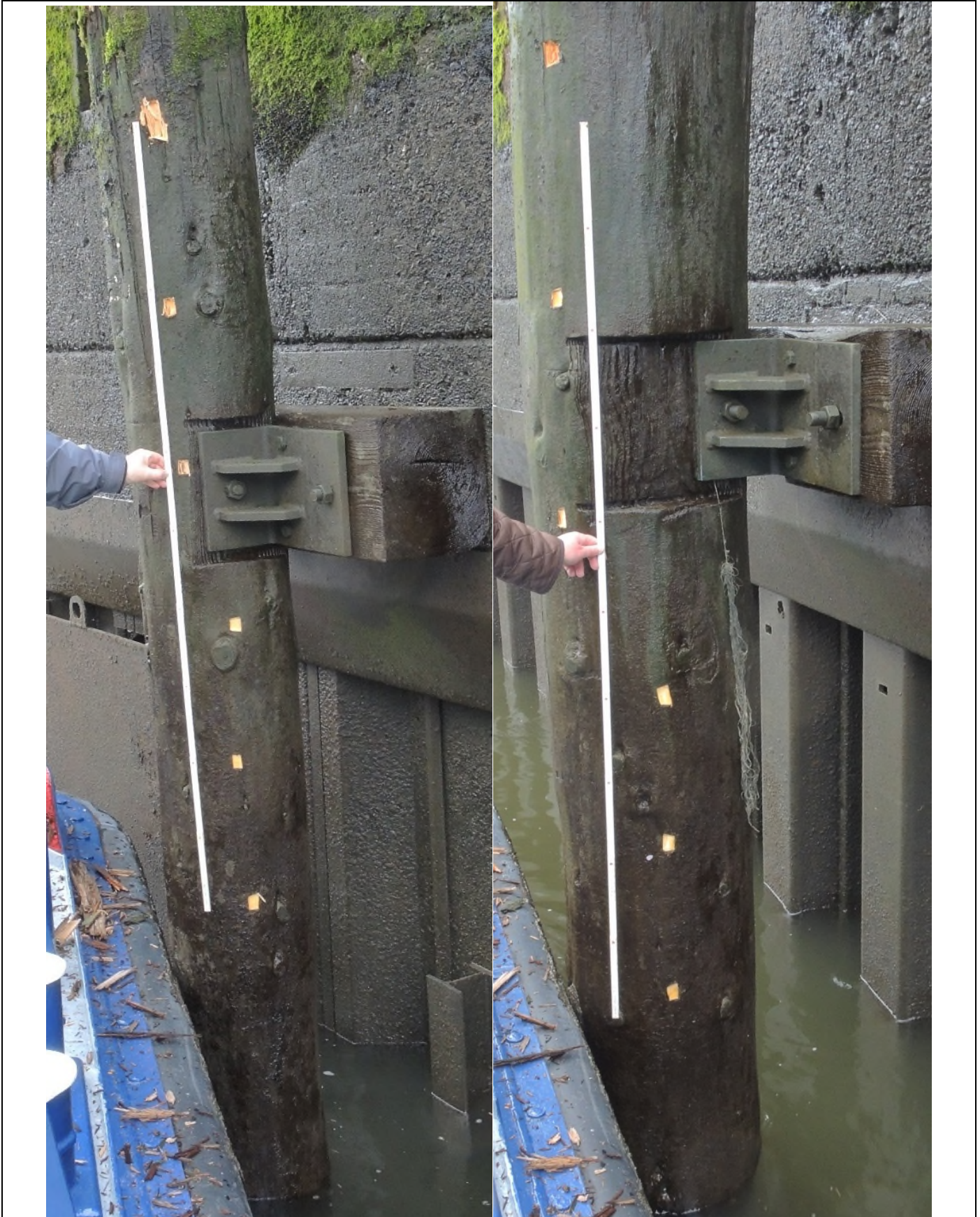
Abb. 73: Hamburg, Museumshafen, Am Sandtorkai; Südseite des Haf Beckens, Dalbe (achte von Osten) mit Verteilung der Probenpunkte; erster Punkt ca. 60 cm über der Wasseroberfläche; Probenahme: 30.03.2017.
