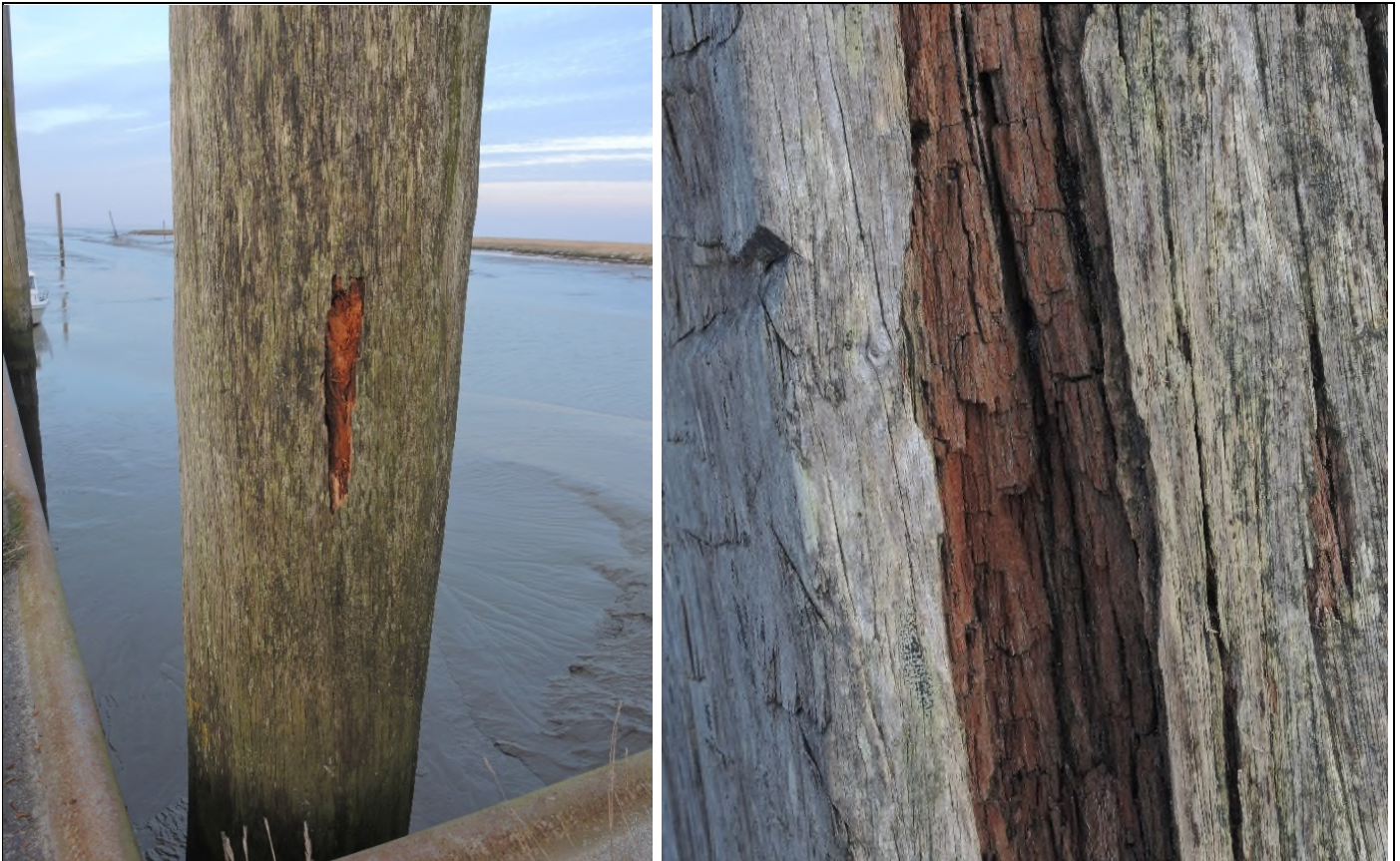
Abb. 13: Übersicht und Detail Nessmer-Siel (links); Südseite; 0,8 m über Kai, Südseite, Nadelholz, Splint, massive Braunfäule sichtbar.
