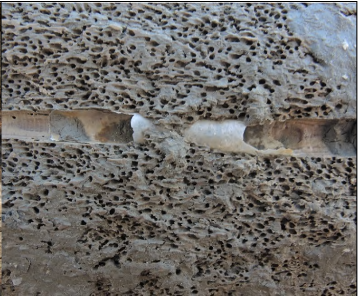
Abb. 42: Detail der tierischen Schäden; Bohrgangwände zudem geschädigt durch Moderfäulepilze und Bakterien.
