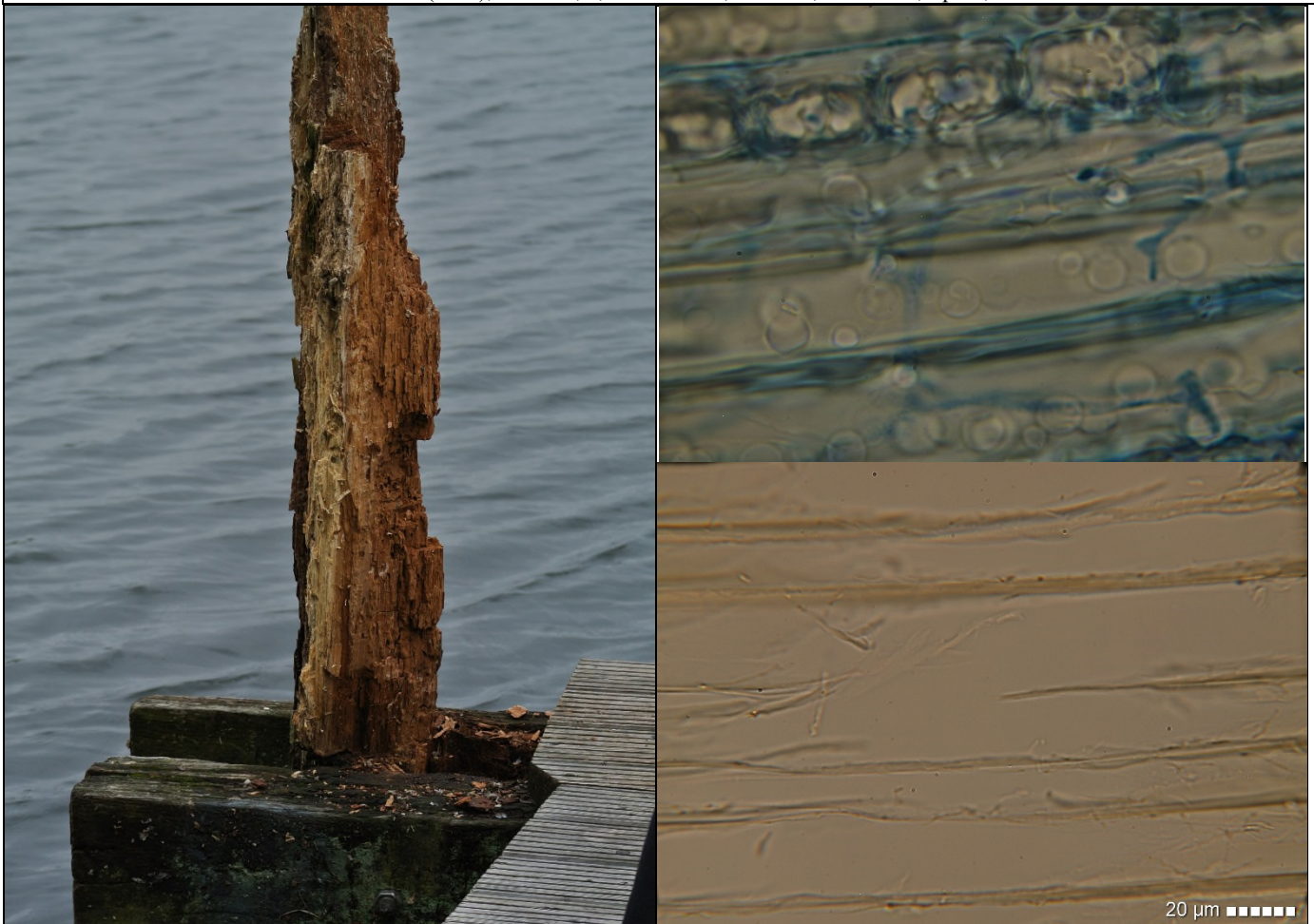
Abb. 14: Mischfäule an einer Dalbe. Im Süßwasser ist der obere Teil oft am stärksten gefährdet – oberer Teil massiv weiß- und braunfaul (final zerstört).
