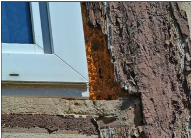
Abb. 9: Typisches Schadensbild im Fachwerk mit fäule-begünstigenden Werkstoff-Kombinationen: Holz-Ersatz führt immer wieder zu Innenfäulen und Substanzverlust. Neben dem unschönen Kunststofffenster, wurde auch mit Bauschaum und Beton die Fäule-Empfindlichkeit der Fachwerkkonstruktion erhöht.
