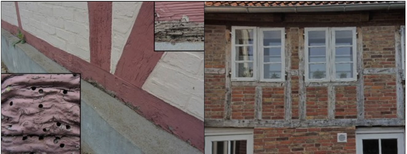
Abb. 11: Spritzwasser erreicht die Schwelle: Die Grund-Schwelle als Verschleißteil: Im Sinne des baulichen Holzschutzes und der Langlebigkeit wäre ein deutlich abgschrägter Sockel sinnvoll: an der Unterseite zerstören Pilze (u.a. Moderfäulepilze) und der Bunte Nagekäfer ( Xestobium rufivillosum ) das Holz; Eckbild: Details der Ausschlupflöcher.
