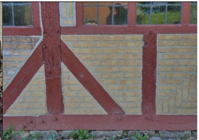
Abb. 10. Die neu gewechselte Schwelle hat fast keinen Spritzwasserschutz. In dieser Konstruktionsweise wird die Schwelle leicht von Pilzen, aber auch Insekten angegriffen und somit zum Verschleißteil. Der Substanzerhalt ist so nur kurzfristig möglich.
