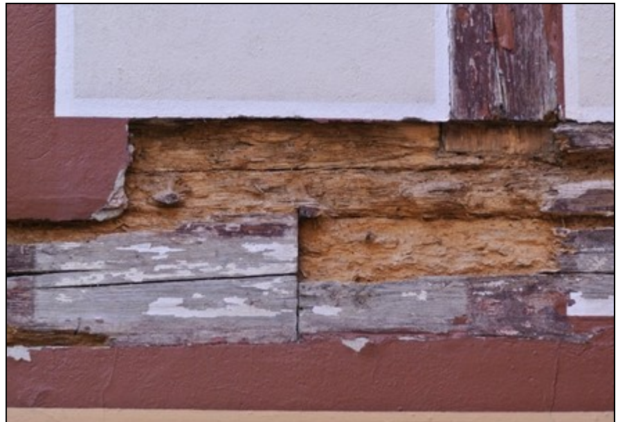
Abb. 2: Typisches Weißfäule-Schadensbild im Sicht-Fachwerk dessen Holz teilweise mit Beton überdeckt wurde. Die Fäule-Schäden finden sich besonders an den Hölzern, die überdeckt wurden.
