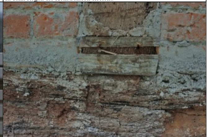
Abb. 16. Fachwerk-„Schutz“ mit einer Putzfassade: Durch die verminderte Abtrocknungsfähigkeit des Holzes unter dem Putz kommt es zu einer außen gelegenen Fäule; hier ein Doppelbefall mit Braunfäule durch einen Kellerschwamm ( Coniophora sp.) und Moderfäulepilzen, zudem ein Insektenschaden durch Bunten Nagekäfer ( Xestobium rufovillosum ).
