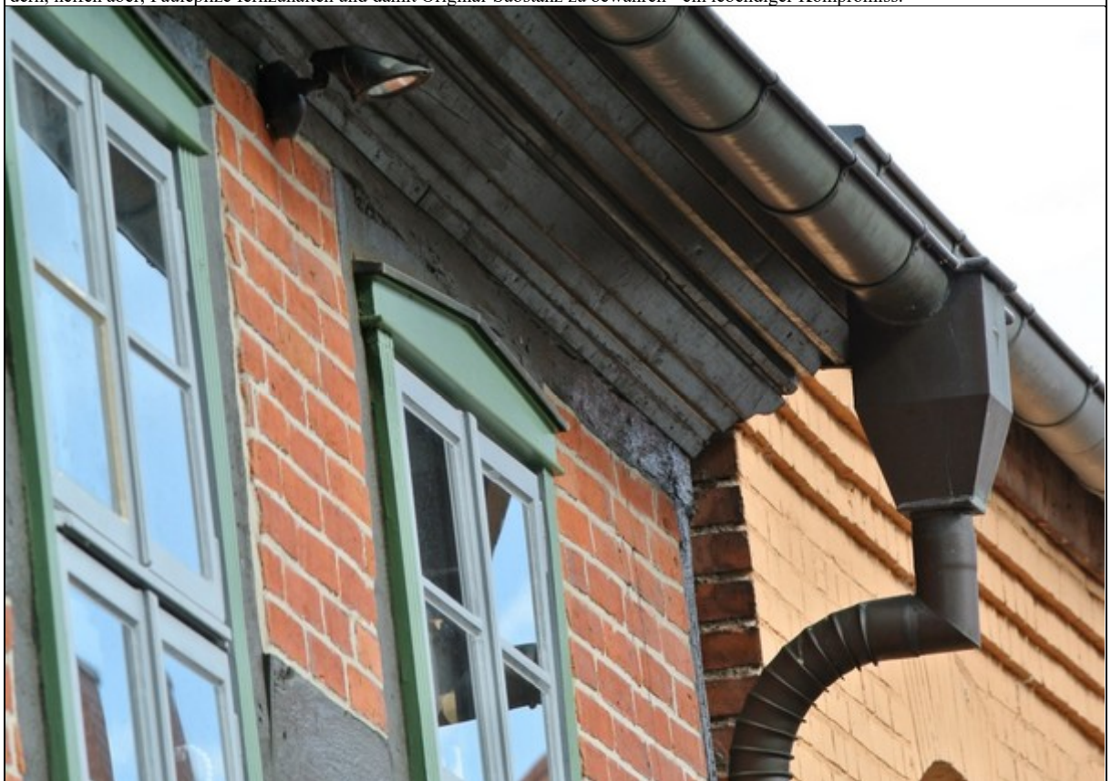
Abb. 18. Regenrinnen sind historisch kaum belegt, helfen jedoch die Wassermenge, die an die Fassade gelangen kann, zu reduzieren, zu dem verbreitert sich der Dachüberstand. Sie dürfen nur in Ausnahmefällen fehlen, vergleichbar einem Blitzableiter, auch dieser wendet größeren Schaden ab.
