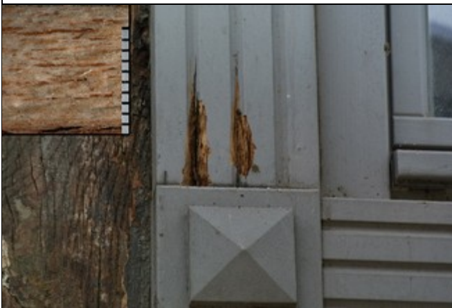
Abb. 15: Sanierung einer Fenstereinfassung und der unterliegenden Pfosten. Wasser fließt nach unten, wird aber kapillar in Ritzen und Spalten gezogen und kann durch die Beschichtung nur schwer wieder entweichen; es entstehen bei nur mäßiger Holzqualität schnell Fäuleschäden, hier eine Weißfäule durch den Großporigen Feuerschwamm ( Phellinus contiguus ). Eckbild: Weißfäuleschaden im Detail: Holz faserig.
