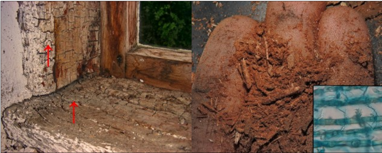
Abb. 3: Museales Fenster mit Braunfäule-Schäden im Blockrahmen (Würfelbruch: Pfeile); das Fenster wurde nach dem Umsetzen des Gebäudes aus den vorgeschädigten Hölzern wieder zusammengefügt. Wenn eine Wiederbefeuchtung ausgeschlossen wird, sind derartige Lösungen möglich, ohne dass es zu weiteren Schäden kommen muss – hier im Freilichtmuseum Detmold an einem leicht temperierten Ausstellungsgebäude.
