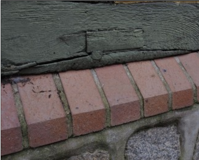
Abb. 13. Im Gegensatz zur Schwelle aus der Abb. 10 kann hier das Regenwasser gut abfließen und Spitzwasser wird von der Schwelle fortgelenkt.
