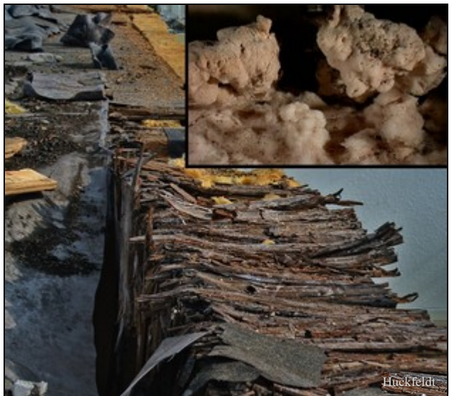
Abb. 5: Eins von fünf gleichartigen Reihenhäusern, die nacheinander saniert werden mussten: Reste von nasse Schalungsbrettern: Ein Warmdach aus feuchtem Bauholz wird oft zur Wasserfalle und zum exquisiten Wohnraum für holzerstörende Pilze. Eckbild: Schalbrett-Unterseite: wolkenähnliche, weiße Dunkelfruchtkörper einer Braunfäuletramete ( Antrodia sp. – Artengruppe Weiße Porenschwämme).
