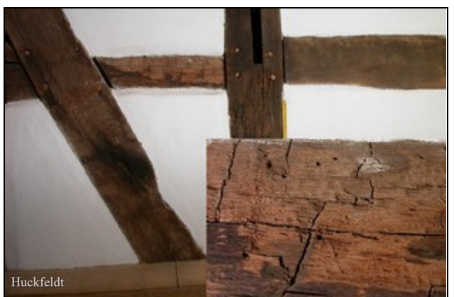
Abb. 6: Braunfäuleschaden mit grobem Würfelbruch: trockener Altschaden am Fachwerk – der Befall ruht; ein Wasserschaden führte zum Wachstum des Kellerschwamms; das Eckbild zeigt ein Detail des Würfelbruchs.
