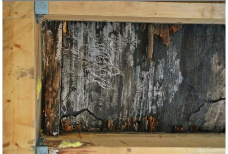
Abb. 1: Flachdach-Schaden nach rund 10 Jahren, die Schalung ist braunfaul und nach dem Entfernen der Dämmung zerbrochen und abgefallen. Sichtbar sind die hellen Stränge einer Braunfäuletramete (Artengruppe Weiße Porenschwämme - Antrodia sp.); an dieser Stelle zeigten die Sparren auf der Oberseite Braunfäule.
